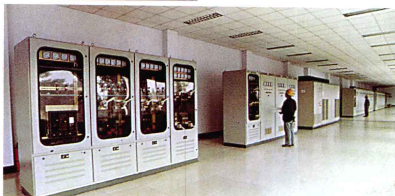
济钢高速线材生产线采用德国西门子公司和美国CE公司全数字电控系统
