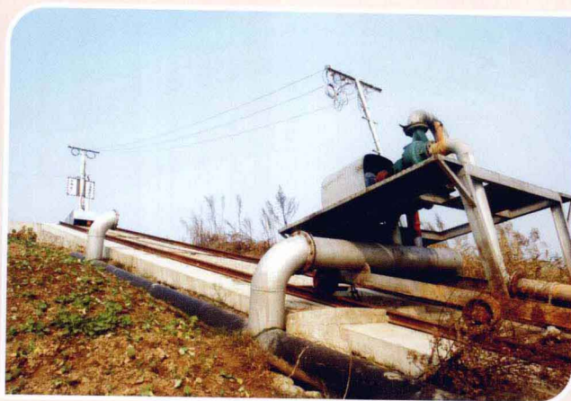
自来水厂北港移动抽水泵
