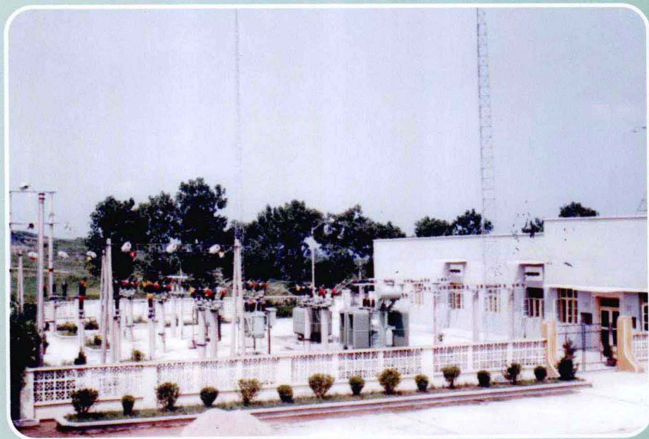
马良变电站（原姚集变电站）
