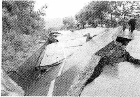
图 1-7 地震产生地面变形
