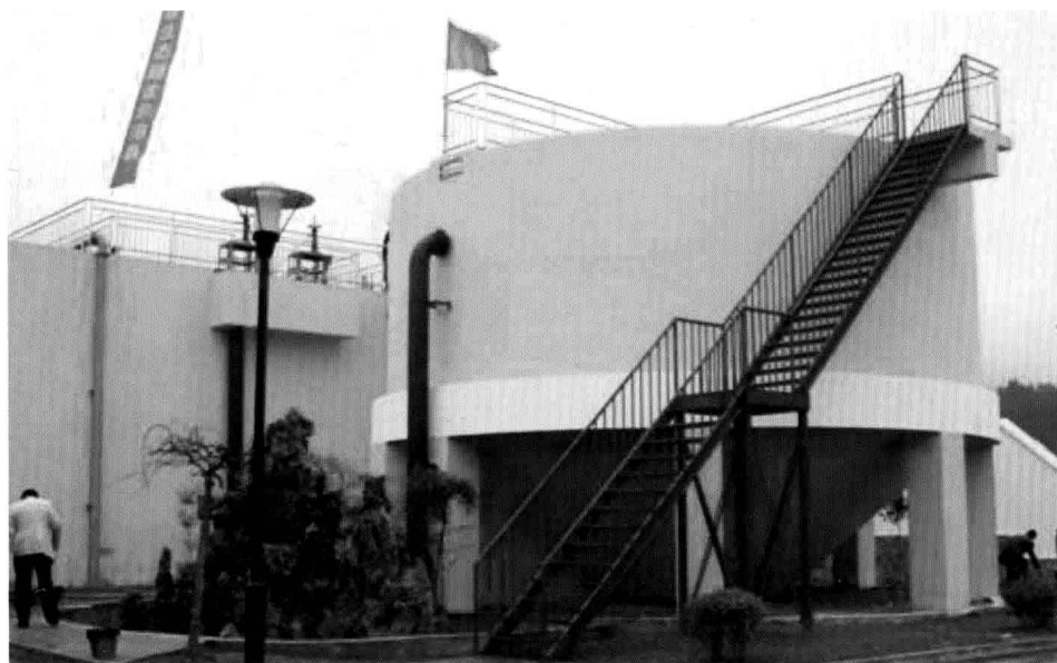
图21 县城污水处理设施（2009年摄）
