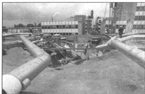
图 1-3 德国某试验室预应力梁断裂
