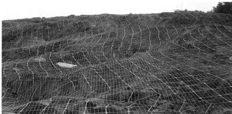
图 5 采取 SNS 柔性主动防护后的边坡
