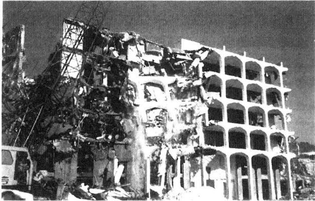
图4 建筑产业会产生庞大的粉尘及废弃物
