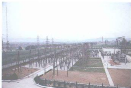
我市电源支撑点、省鹅湾 220KV 变电站。
