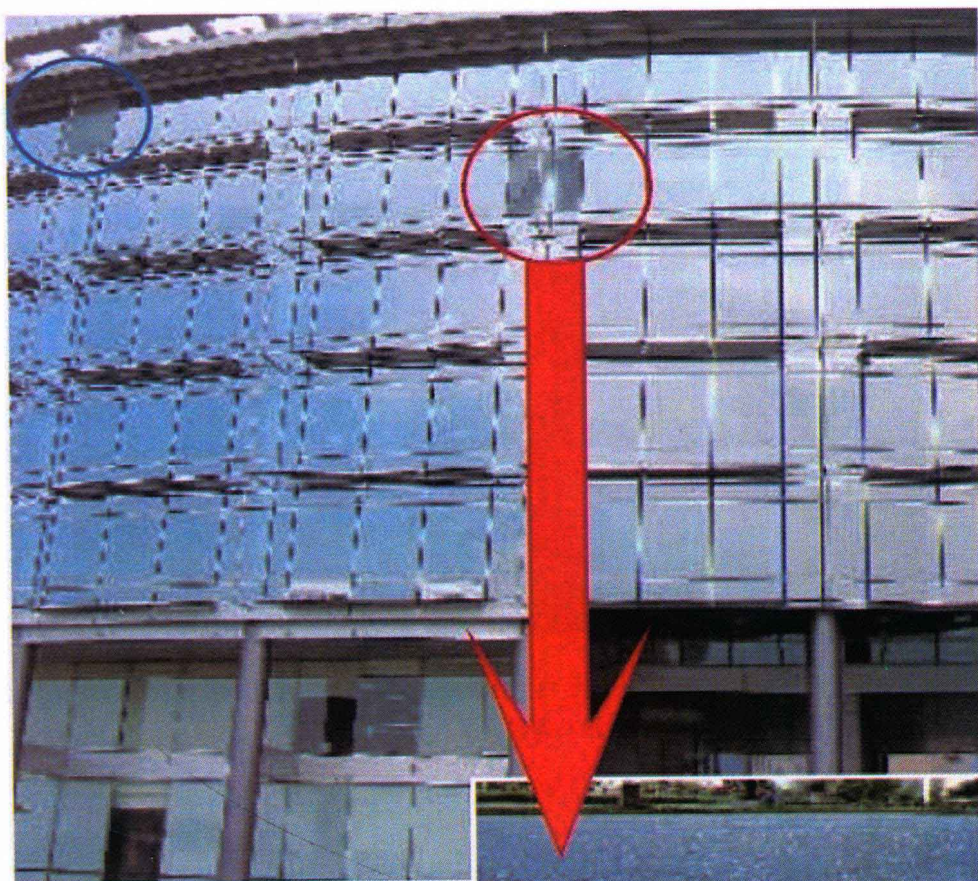
玻璃从图书馆玻璃幕墙（红圈处）上掉落后，碎片散落一地。在这块玻璃附近，还有一块玻璃发生了开裂（蓝圈处）。再杰摄
