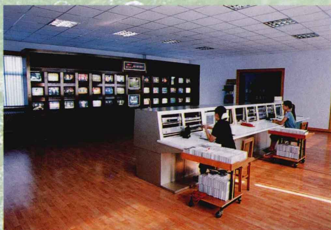
电视台监控室
