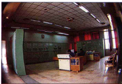
△ 淮阳 220KV 变电站控制室
