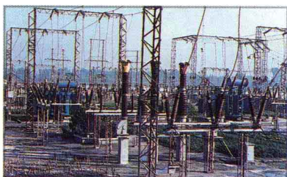
△ 扶沟县 110KV 变电站
