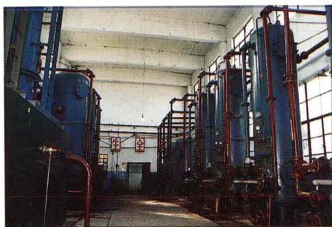
△ 沈丘县电厂化水车间
