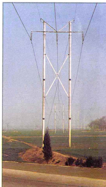
△ 110KV 输电线路
