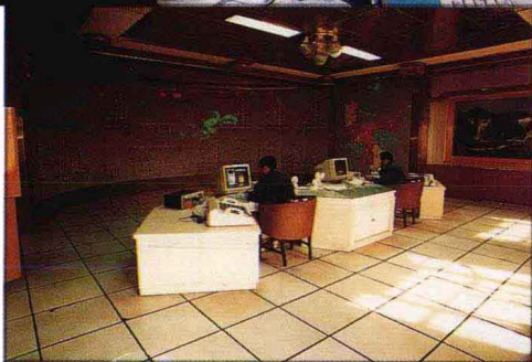
◁ 地区电力调度中心
