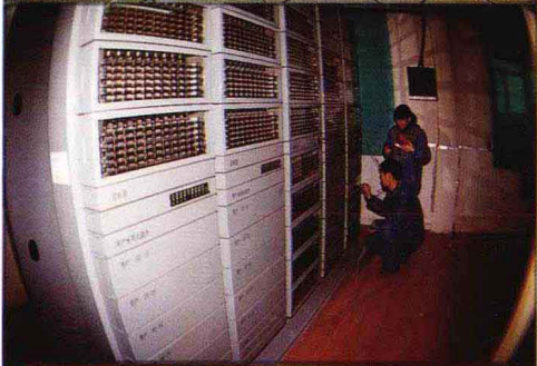
◁ 地区电业局程控交换机
