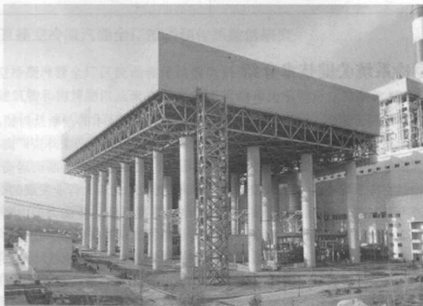
图 1-1-1 火力发电厂空冷岛
