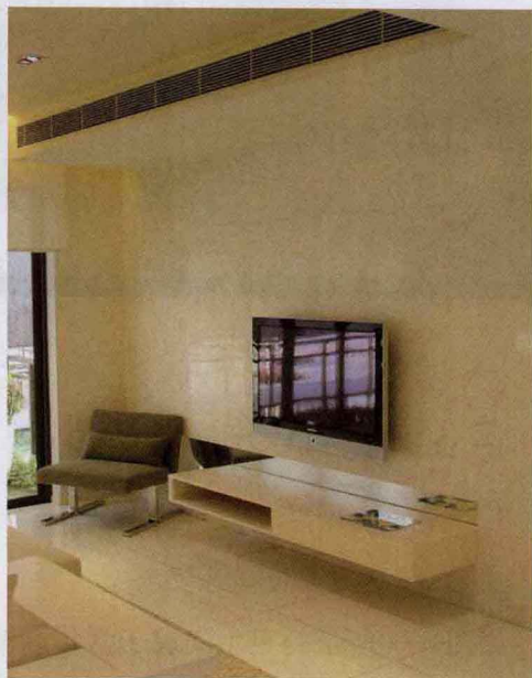
图1—9 顶棚二级吊顶内安置了空调出风口
