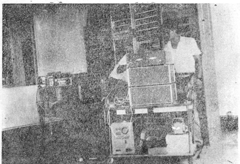
②② ↑120路微波机(1990年5月安装)
