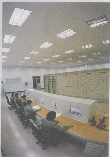
供电系统主控室
