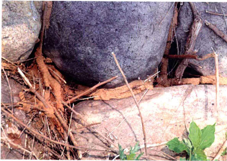
迎水坡护石间黑翅土白蚁的泥线
