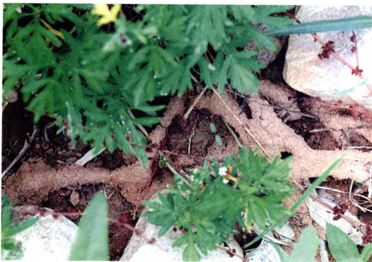
迎水坡护石间黑翅土白蚁的泥线
