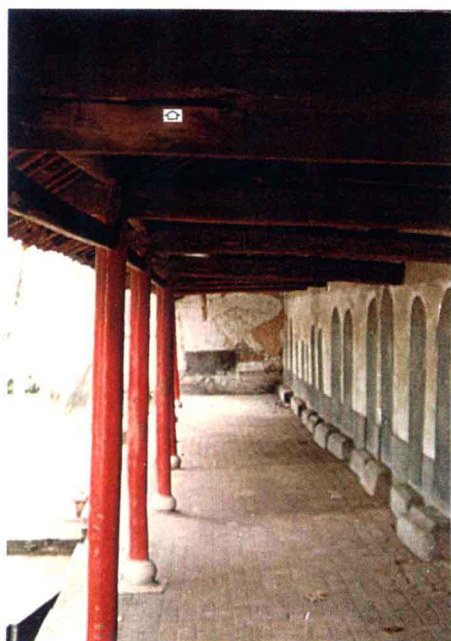
被白蚁蛀蚀的廊檐（南阳武侯祠，1978. 5）
