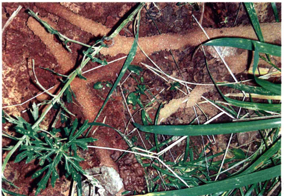
背水坡草皮上黑翅土白蚁的泥线
