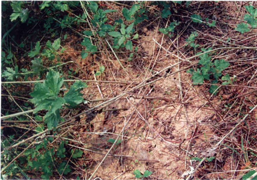
背水坡草皮上黑翅土白蚁的泥线相连成泥被
