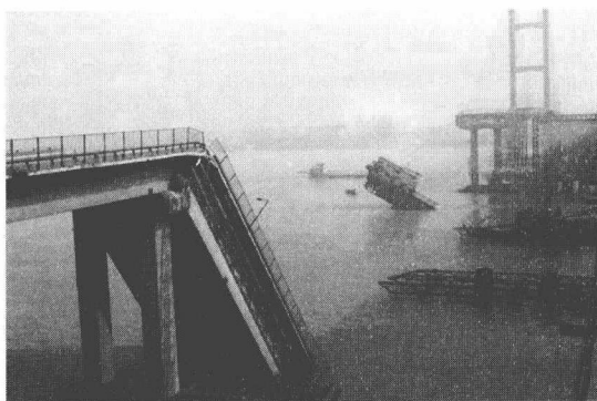
图 1-3 广东九江大桥垮塌
