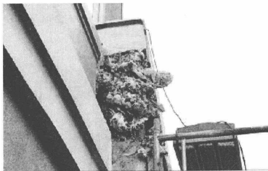
图 1-7 上海苏州河河南路桥桥墩内垃圾
