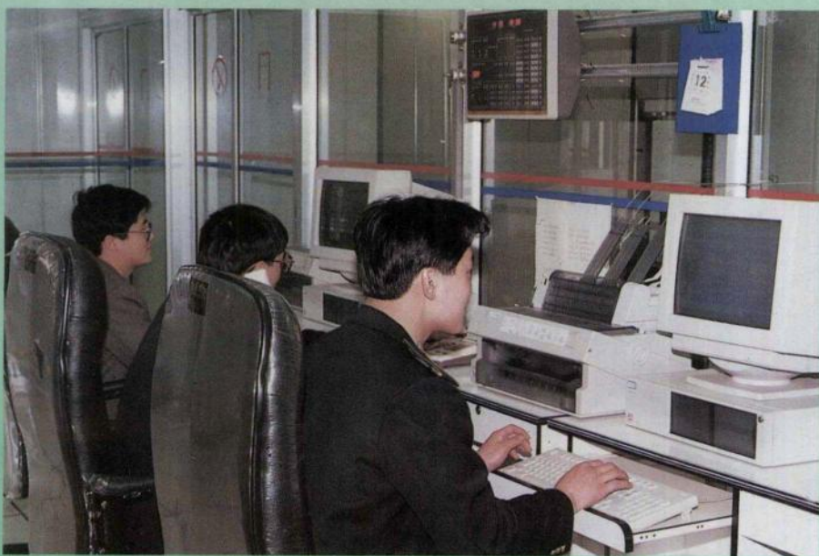
程控电话机房
