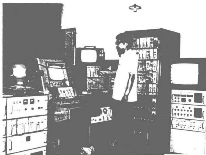
洛陽電視台電視電影机房一角
