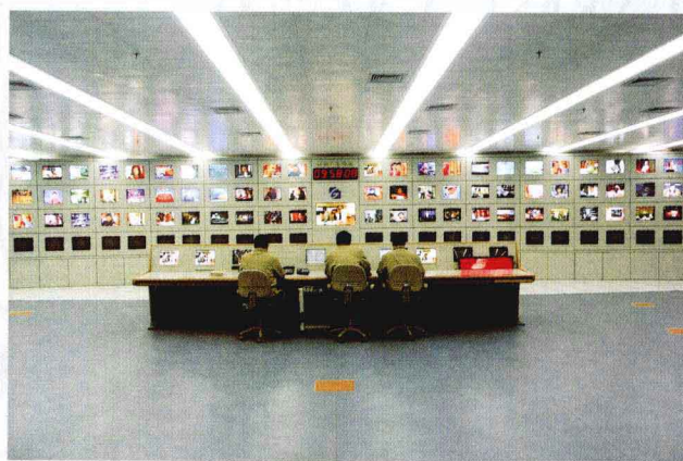
广电网络现代化机房
