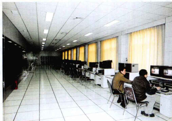
洛阳电视台新建的 800 平方米编辑机房
