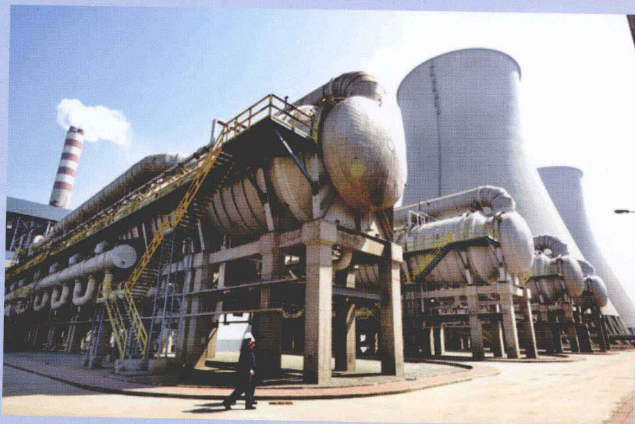
2011年3月31日，天津国投北疆电厂海水淡化一期工程竣工投产，标志集发电、海水淡化、浓海水制盐、废弃物资源化再利用、土地节约整理“五位一体”的循环经济产业链条实现成功运转，发挥出巨大经济效益、社会效益和环境效益
