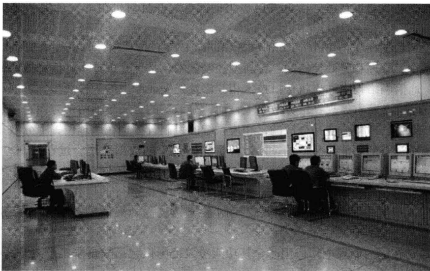
图 1-1 单元机组运行集控室
