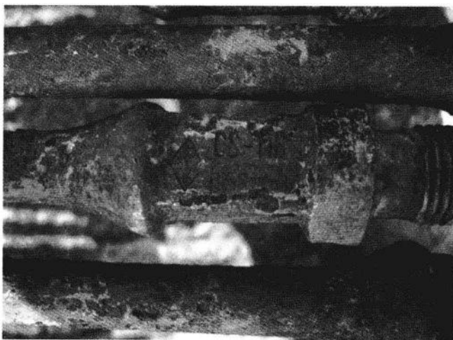
图1-3 抽油杆表面多处坑蚀
