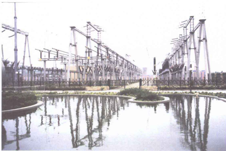
西官庄 220KV 变电站
