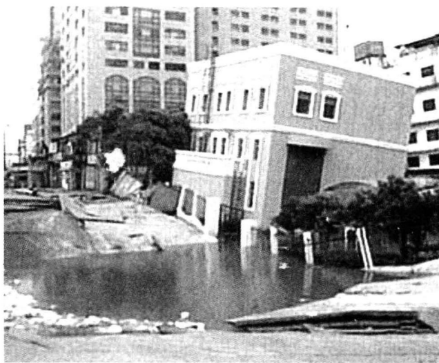
图 1-4 地面塌陷、建筑物倾斜
