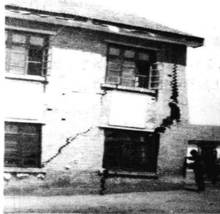
图 1-3 地基强度破坏引起建筑物开裂
