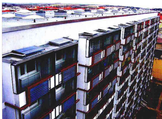
图 2-14 太阳能热水系统建筑一体化实例 10
