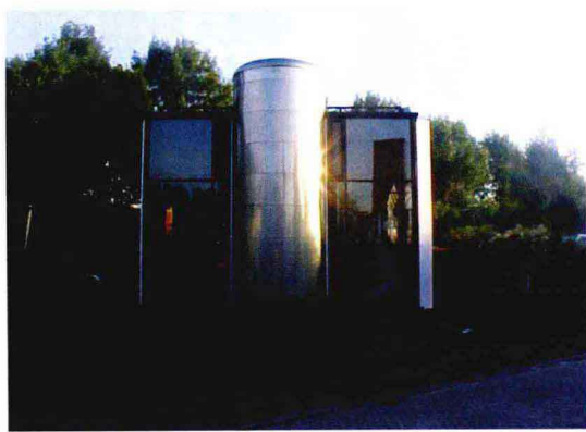
图 2-6 太阳能热水系统建筑一体化实例 2
