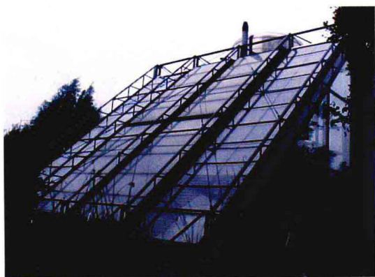
图 2-5 太阳能热水系统建筑一体化实例 1
