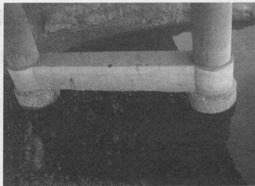
图 1-27 由于水冲刷使桩基外露
