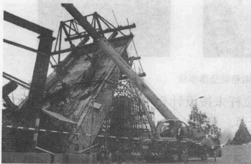
图 1-7 桥梁倾覆事故
