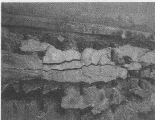
图 1-28 某空心板桥底部混凝土松散情况
