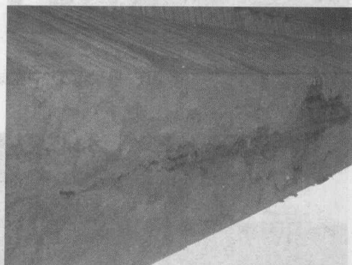
图 1-15 箱梁底部露筋、混凝土松散
