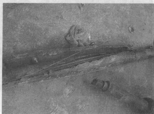
a)斜拉索PE管老化情况
