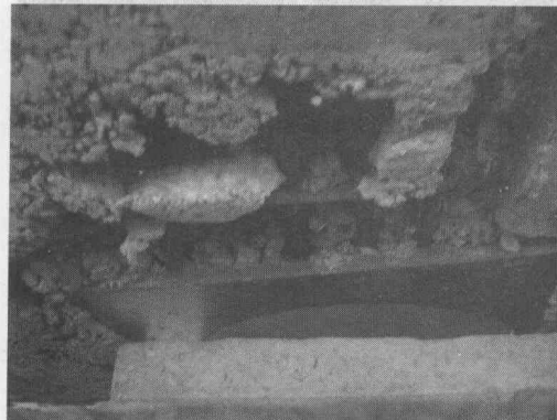
图 1-14 支座上部露筋、混凝土松散
