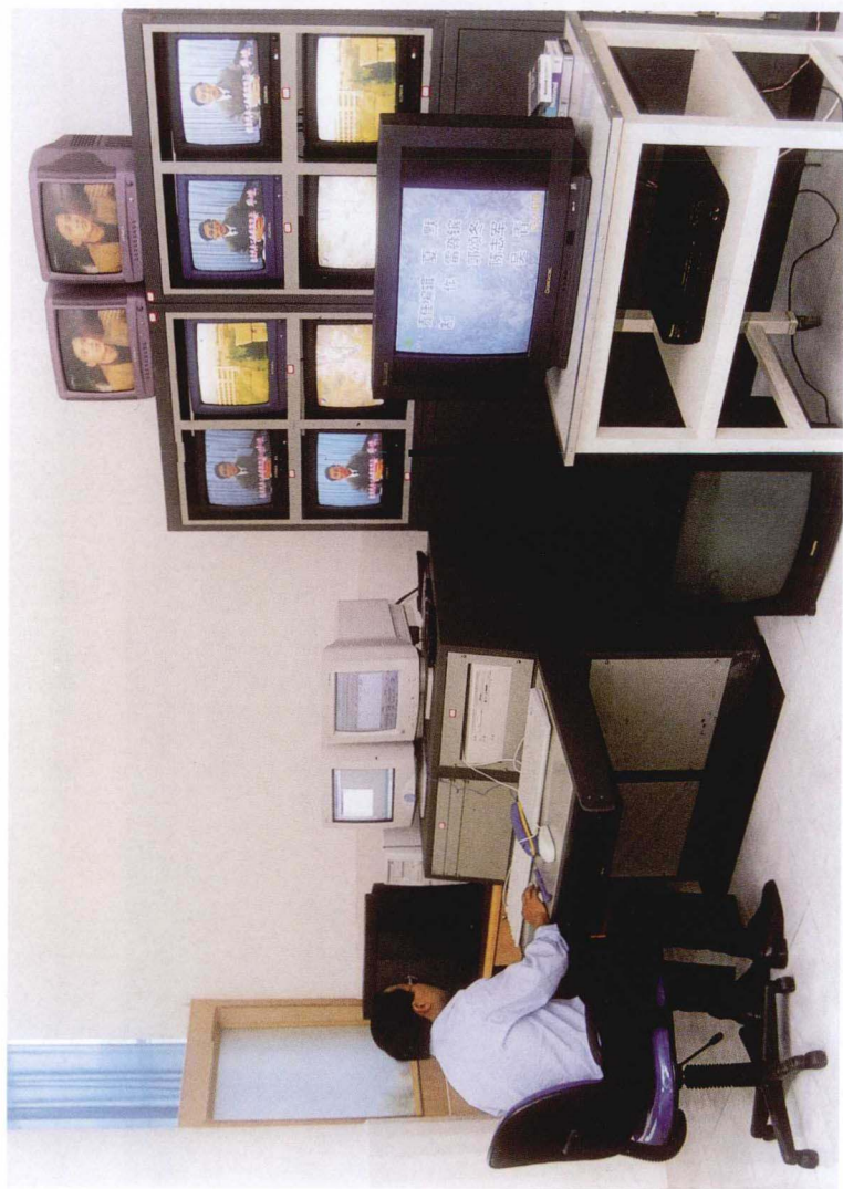
玉溪一中闭路电视教学双向控制系统播控中心
