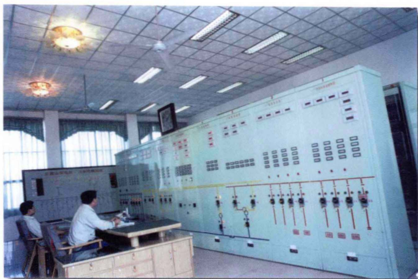
中峰云煤一矿35KV变电站控制室
