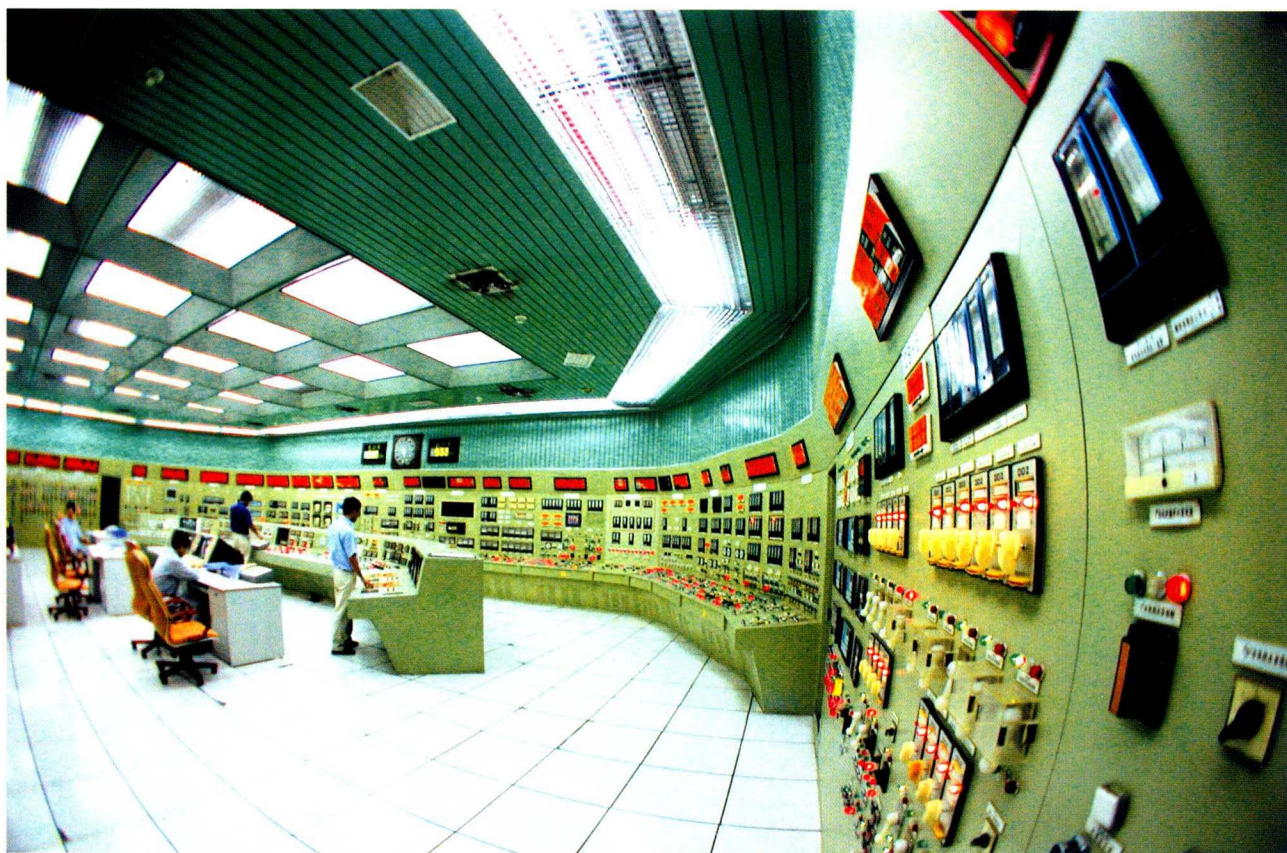
秦山核电站主控制室
