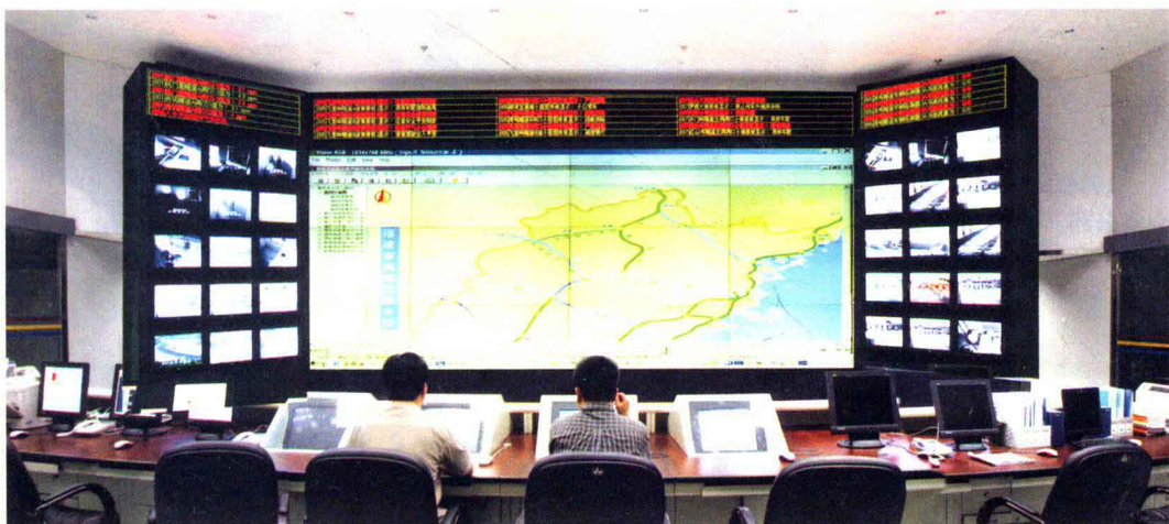
福建省高速公路监控中心
