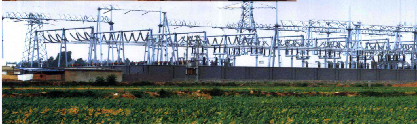
淇县 220 千伏变电站（2010 年 12 月投运）
