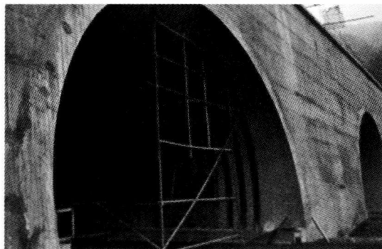
图 1-2 偏压致隧道衬砌开裂
