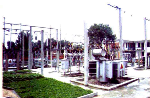
农场供电局35千伏场部变电站
