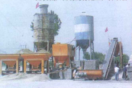
二处机械厂自制的稳定土厂拌设备
