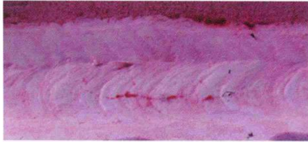
图70 手工电弧焊钢构件角焊缝上的裂纹 (着色渗透检测)
