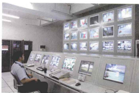
深圳市天健物业管理有限公司某小区 监控中心
