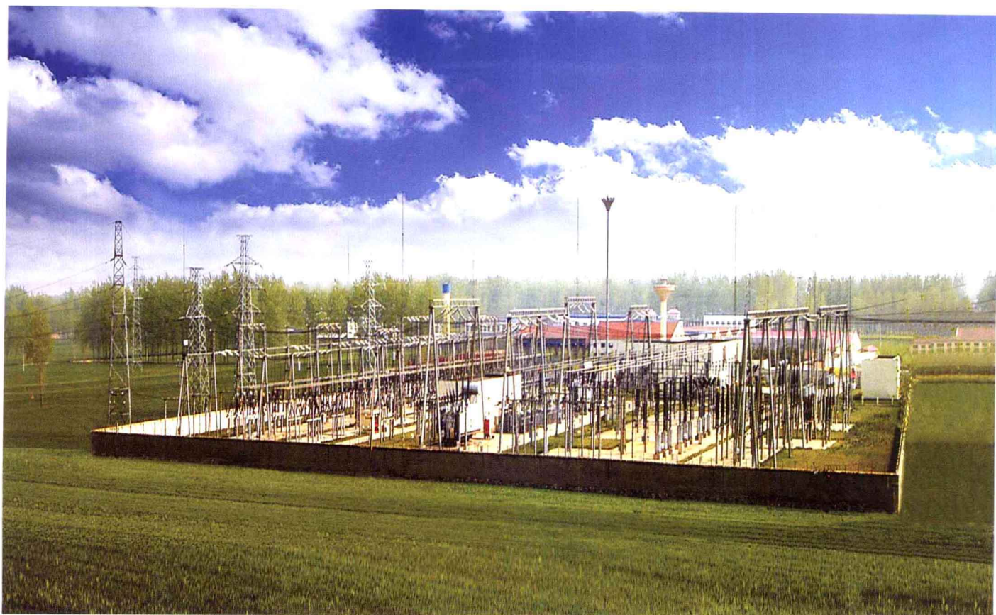
220千伏水寨变电站（2000年12月投运）
