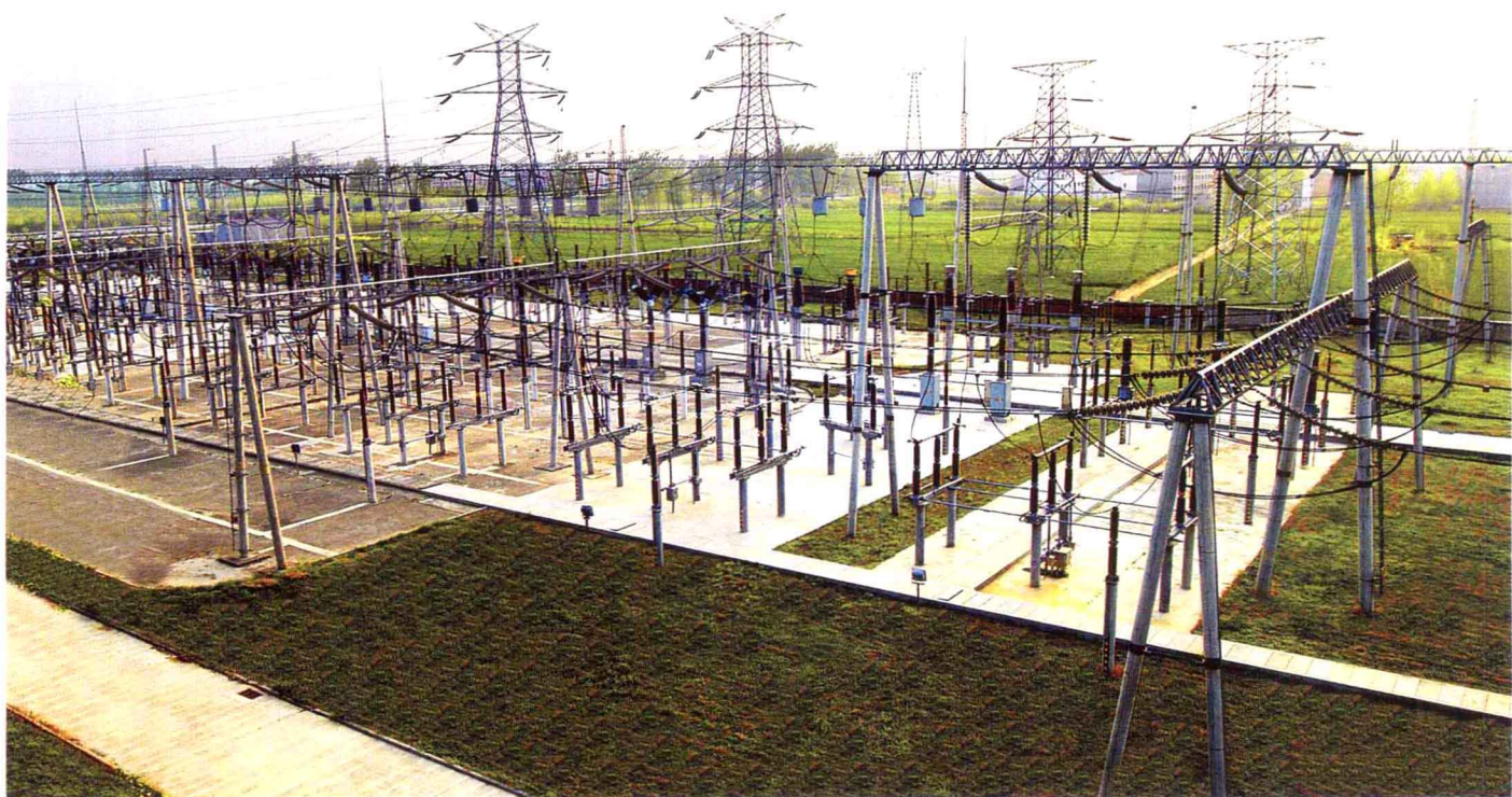
220千伏淮阳变电站（1988年11月投运）
