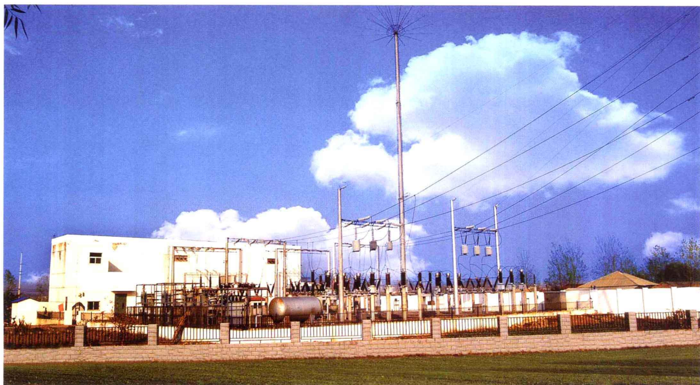
110千伏富民变电站（2003年9月投运）
