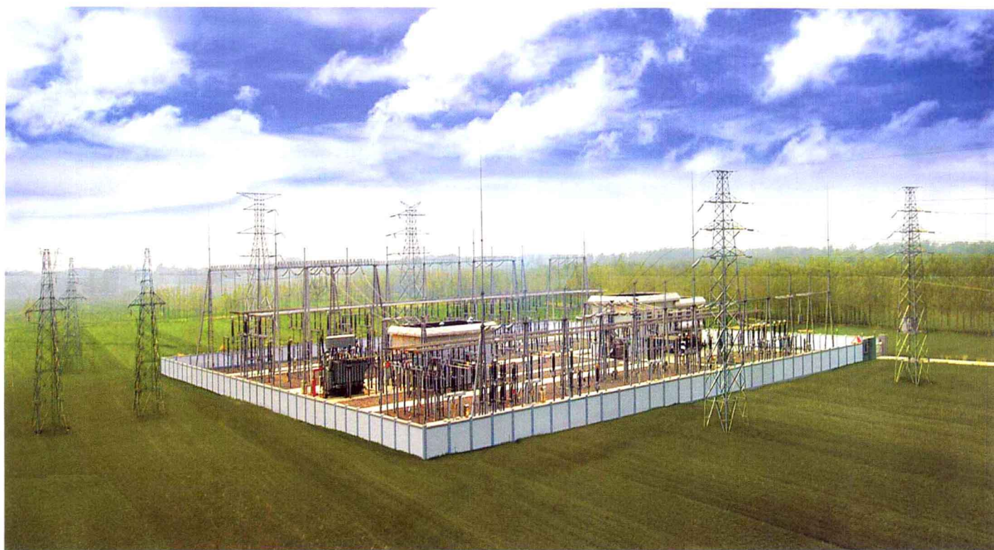
220千伏荷花变电站（2008年6月投运）
