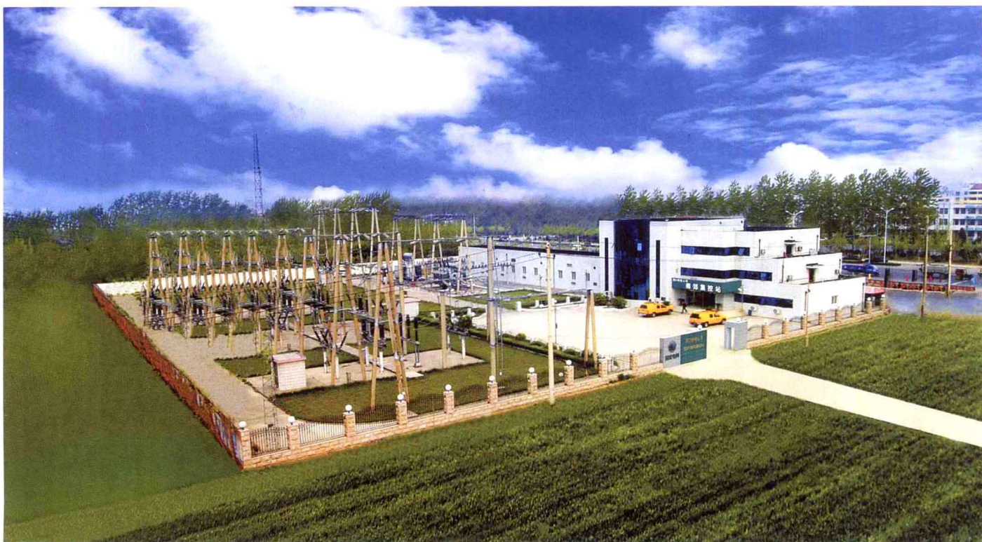
110千伏南郊集控站（1998年7月投运）
