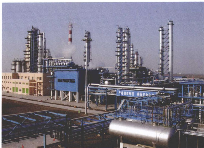
重油加氢精制项目
