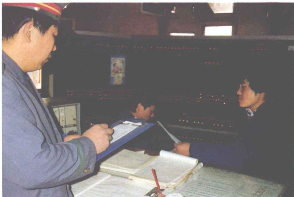
上街车站大站电气集中控制台
