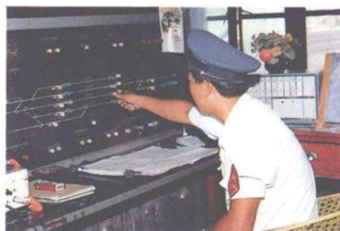
小站电气集中控制台
