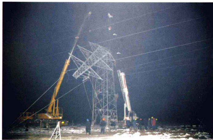
2009年11月11日，周口遭受历史罕见的冰灾，电网受损严重，周口供电公司组织人员顶风冒雪，不惧严寒，彻夜抢修。
