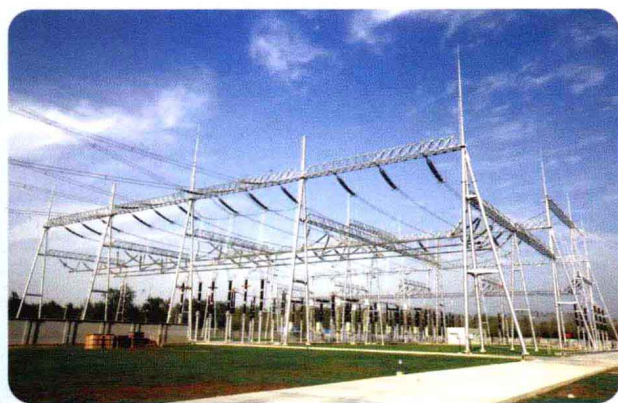
2009年12月周口第一座500千伏变电站周口站投运
