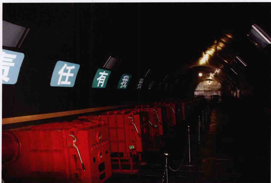
井下二水平变电所
