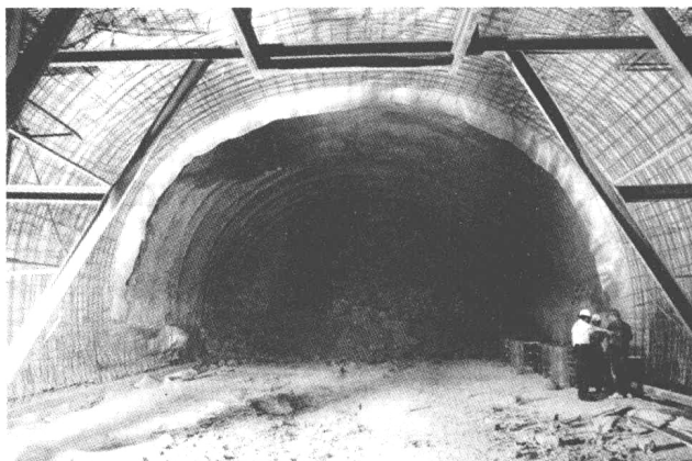
图 1.1 大连市在建南山隧道坍塌正面截图
