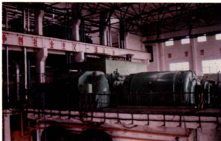
正常运行的#3、#4 发电机组
