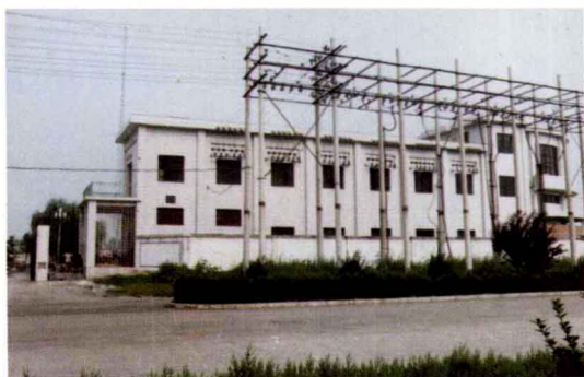
城郊 35KV 变电站
