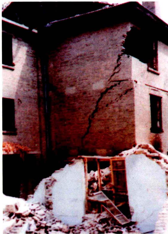
西北大学研究生楼被地裂缝破坏情况 （张家明，1990）
