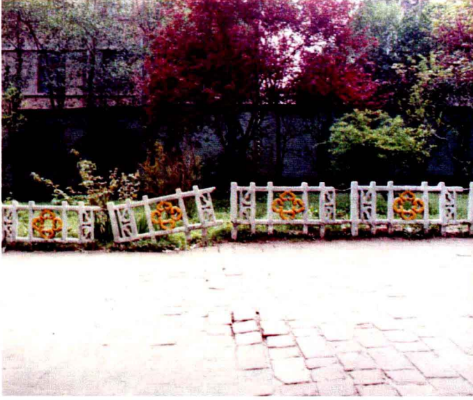
陕西省委西院家属楼东墙外护栏被破坏和路面开裂 (镜向西)
