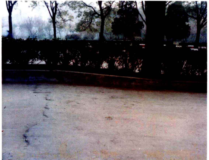
省委西院东墙外慢行道和道牙开裂并向南倾落
