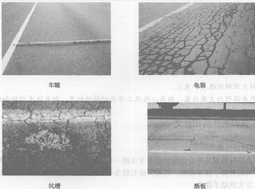
图 0—1 道路路面常见病害
