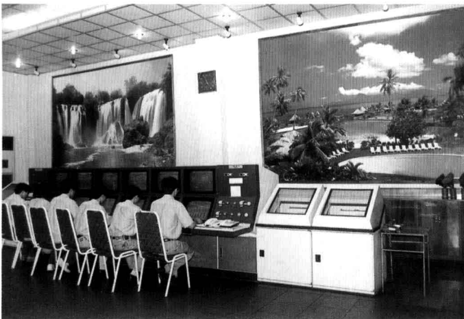
尿素车间总控室
