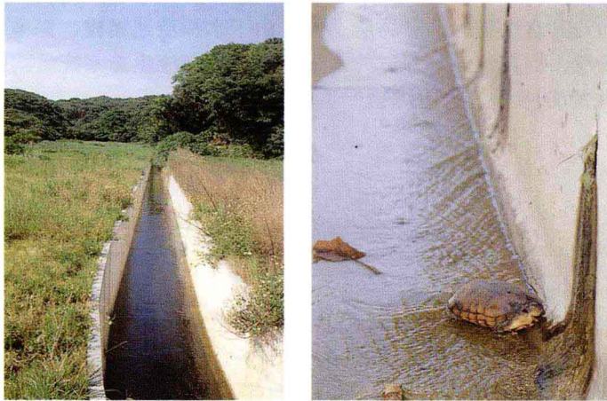
照片 1-3 混凝土渠道阻断了生物的移动路径 (引自文献 1)
