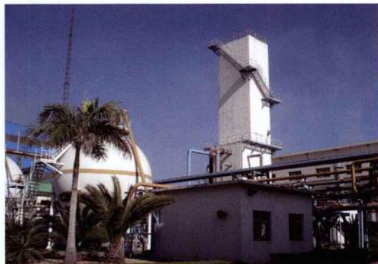
中钢石家庄设计院设计的某钢铁公司氧气站之一角
