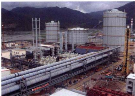
中钢石家庄设计院设计的某铁合金公司干式煤气柜系统
