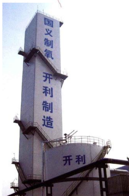
公司为唐山国义特种钢铁有限公司提供的20000m 3 /h空分设备在运行中
