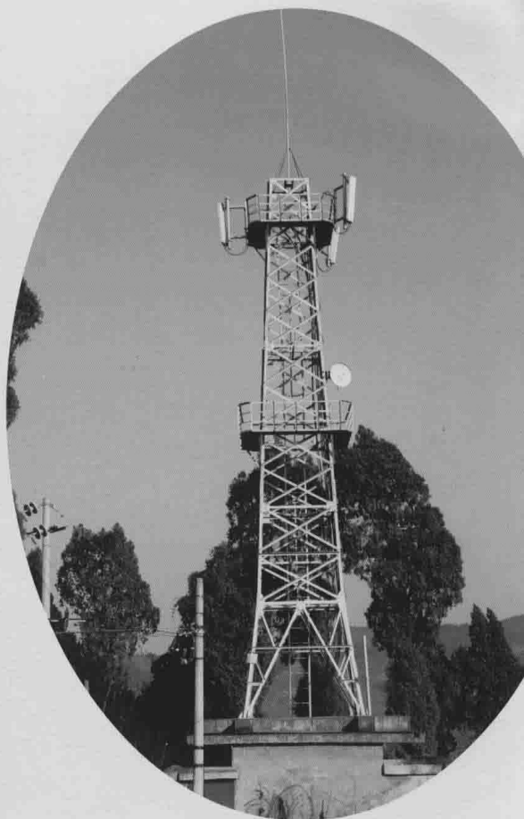
移动通讯基站铁塔
